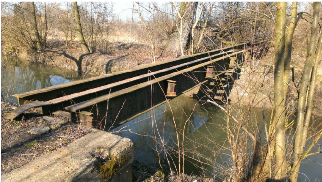
Ilustracja 1: Stan techniczny konstrukcji mostu na rz. Nidzica umożliwia budowę kładki rowerowej. zdjęcie: Jacek Ziebur
